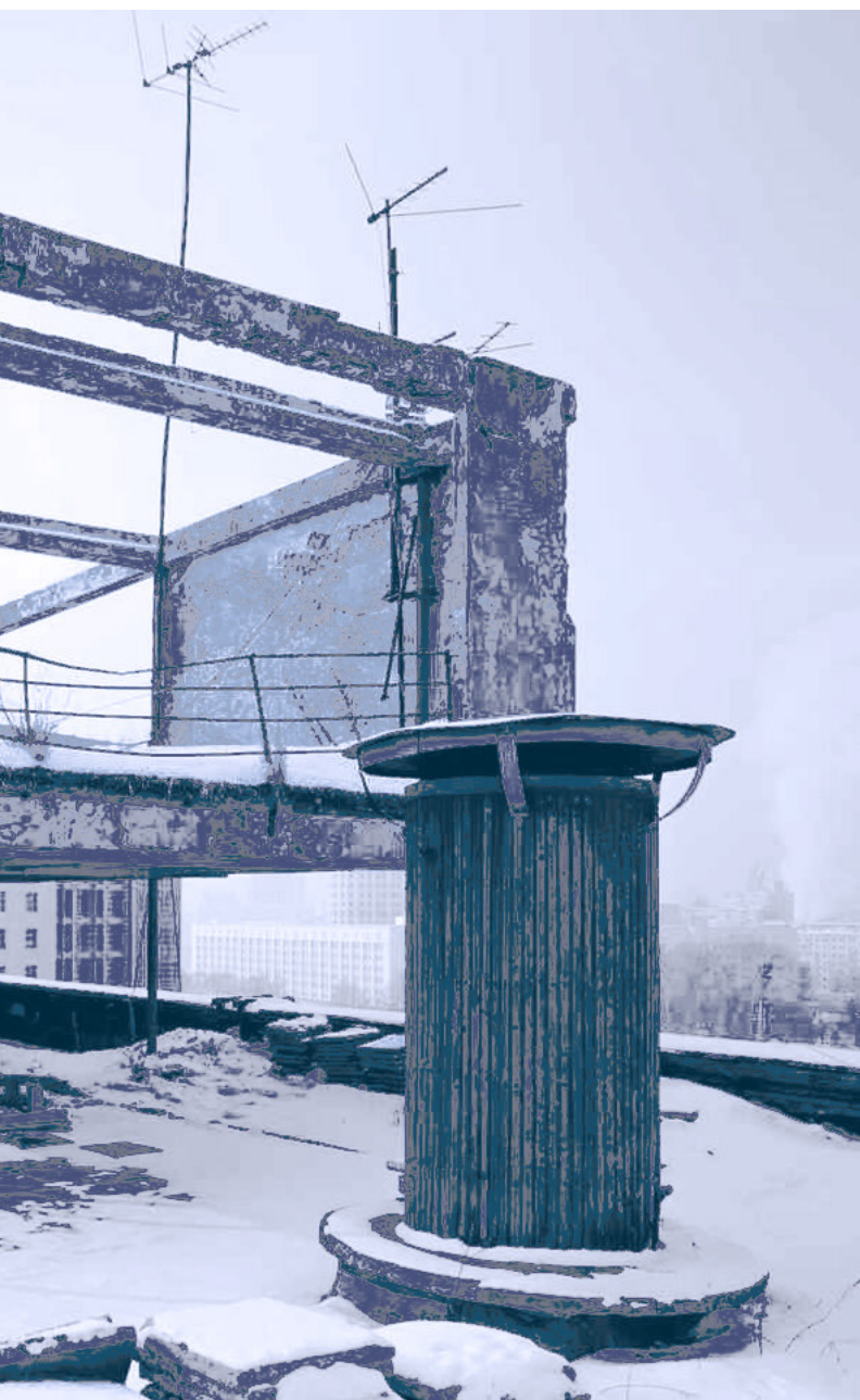
F36-Estado de abandono
